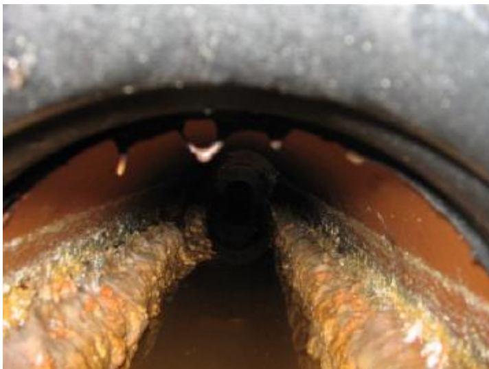
Fett i ledningsnett er et økende problem
